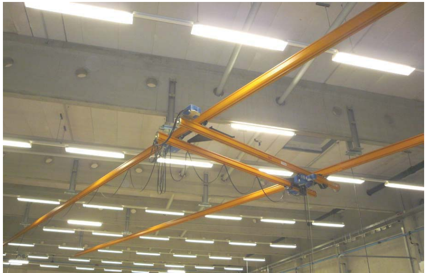
Sonder-Hänge-Kranbahn mit Sonderhalterungen, diagonal montiert.
