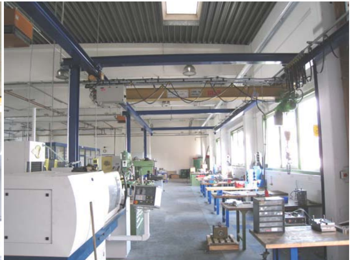
Oben: Sonderkranbahn und mit Montage eines umgebauten Kranes. Komplette Projektierung, Montage und Abnahme durch MSR
